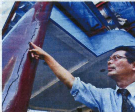
PEGAWAI di Jabatan Penerangan Sabah, Iskandar Ismail menunjukkan kesan retakan akibat gegaran di Wisma Dang Bandang selepas kejadian gegaran yang dirasai di Kota Kinabalu semalam.
